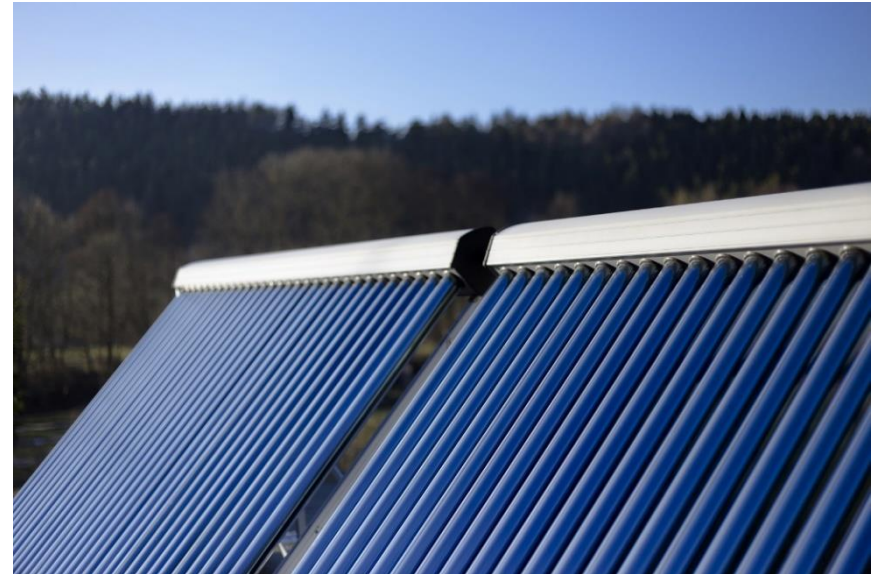
Solarthermie – hier Vakuumröhrenkollektoren
