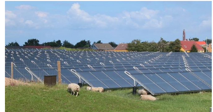
Flachkollektoren Quelle: Projekt Nahwärmeversorgung Marstal
